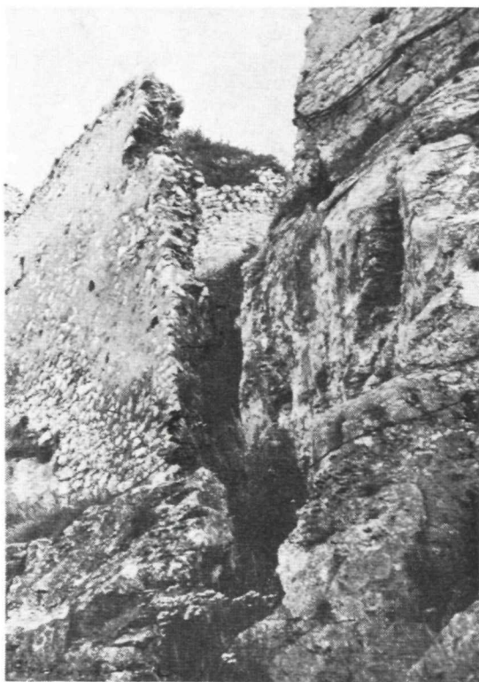
Foto 2. Otvorená trhlina oddeľujúca okrajový blok Perúnovej skaly (vpravo), ktorý sa posúva doprava a zároveň dvíha. Dlhodobý plazivý pohyb bloku spôsobil aj deštrukciu hradného múru
